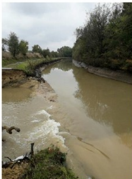
Brèche dans le bief de l'Evêque à l'amont du pont de la Mijane sur la commune de Villmoustaussou Mardi 16 octobre 2018 à 15h00
