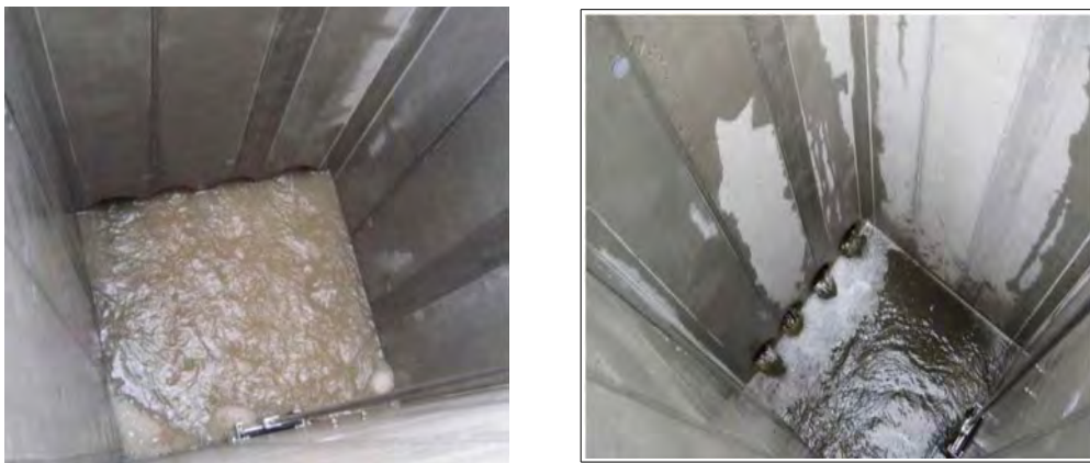
Figure 52: Grille de filtration pendant l'écoulement des eaux pluviales et après écoulement (Entwicklung von Methoden zur Prüfung der Eignung von Substraten für die Oberflächenwasserbehandlung von Dach – und Verkehrsflächen, Fördervertrag GZ B100121, Lebensministerium, 2013)
