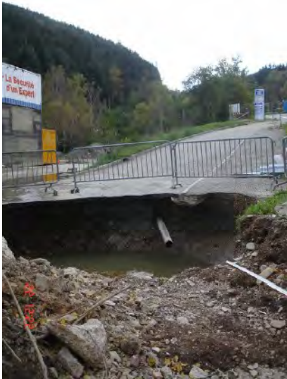
Figure 44: Route effondrée au droit d'un ouvrage hydraulique suite à des pluies cévenoles en Lozère (Photo : Cerema Méditerranée)
