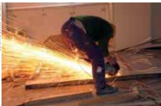
La réhabilitation de l'immeuble administratif de la rue Dutôt à Paris fait partie des principales réalisations de l'exercice 2004.
