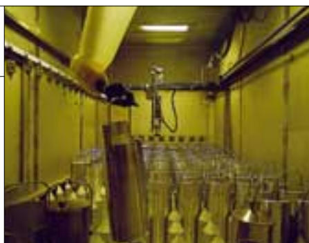
Caisson de télémanipulation. Installation Phébus.
